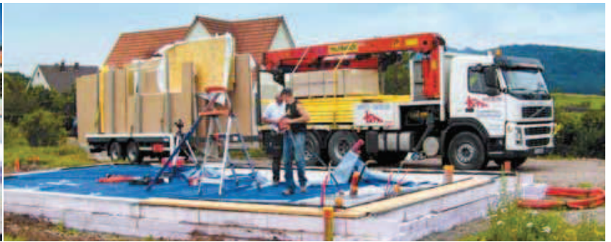
La dalle est coulée, les panneaux arrivent par camion déjà équipés de l'isolation.
