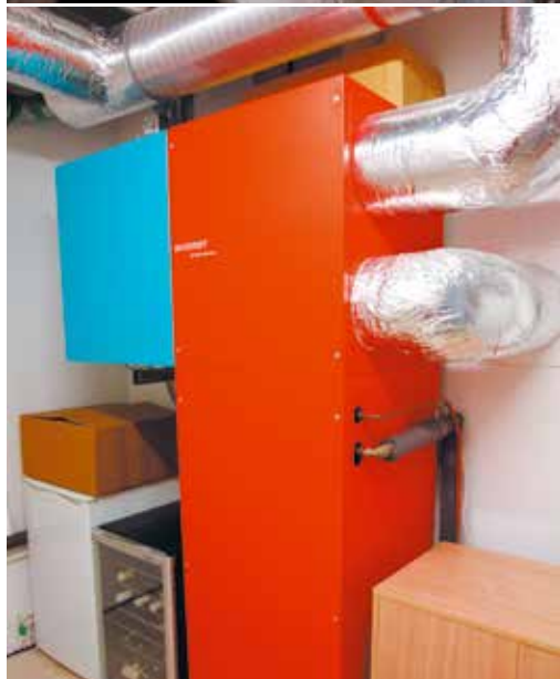
L'Aérosmart de Drexel & Weiss est couplée sur un puits hydraulique. Elle assure ventilation, chauffage sur l'air et eau chaude sanitaire. Aucun autre appoint de chauffage n'est installé dans la maison !
