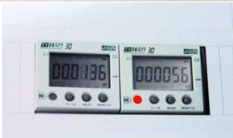
La domotique permet d'automatiser les réglages pour un confort constant.
