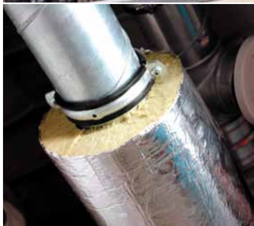
L'isolation des gaines de ventilation et autre canalisation : à ne pas négliger !
