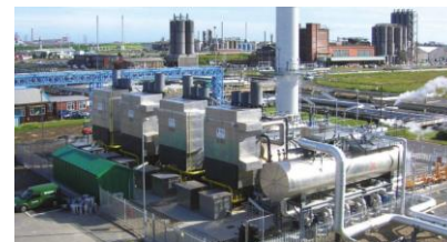
Chaudières à vapeur, Sembcorp (GB)
