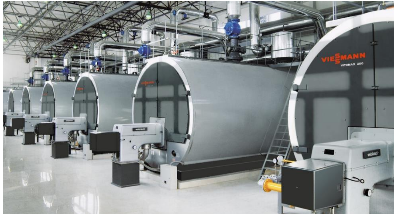
Chaudières à eau chaude avec brûleurs gaz, Xi'an (Chine)
